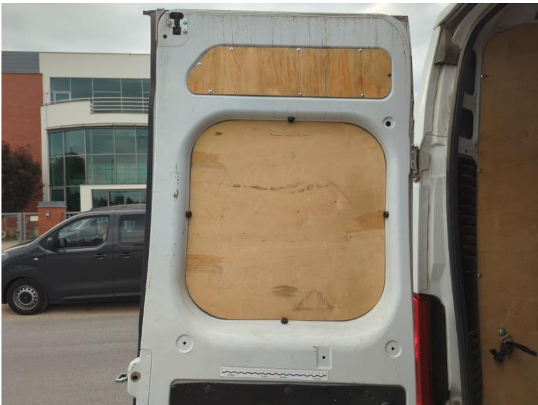
Fot. 112 Drzwi() - Rysa/odprysk 3
