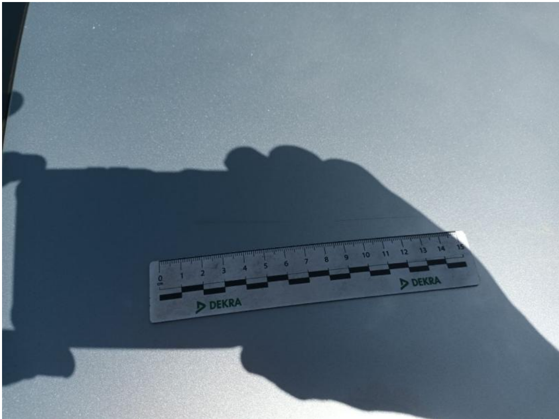
Fot. 59 Dach - Rysa/odprysk 1
