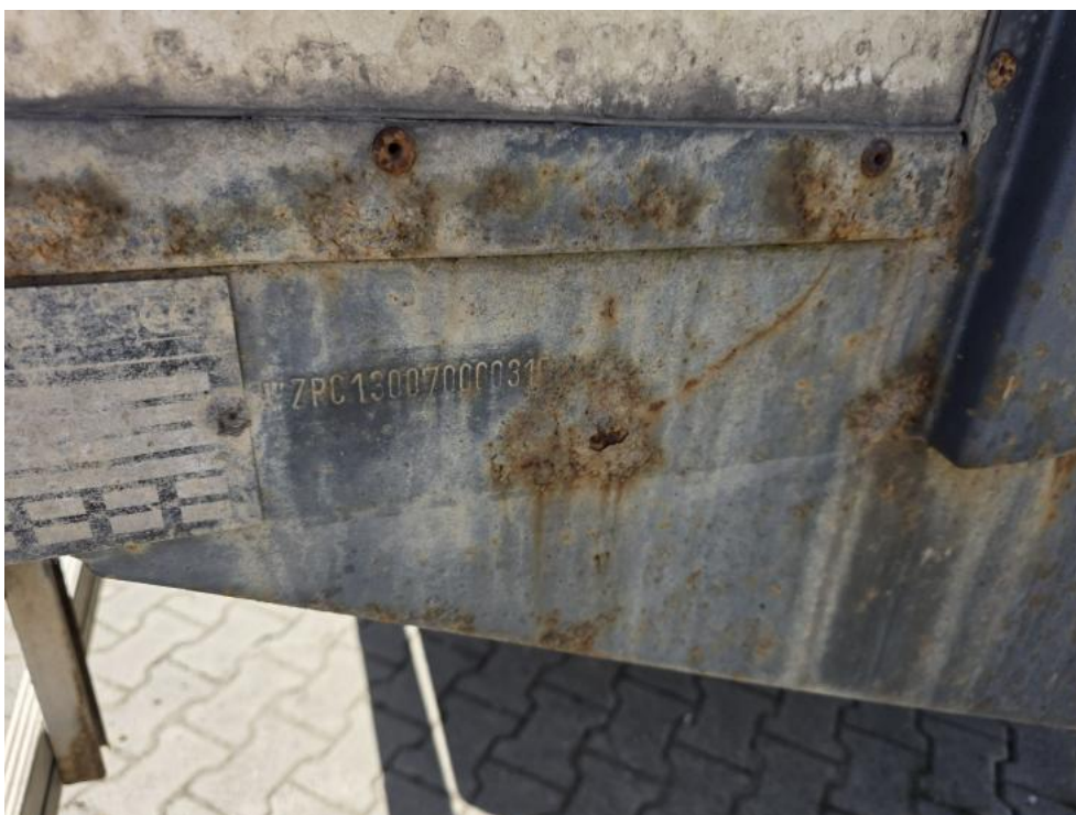
Fot. 48. Korozja blisko numeru VIN
