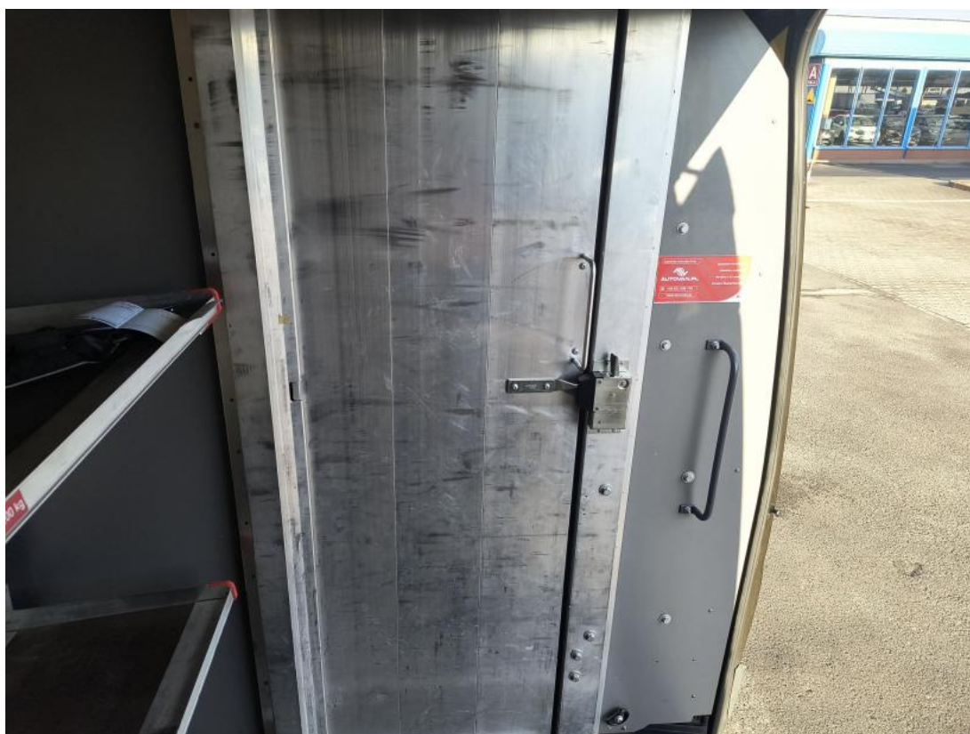
Fot. 116 Drzwi - Rysa/odprysk 1
