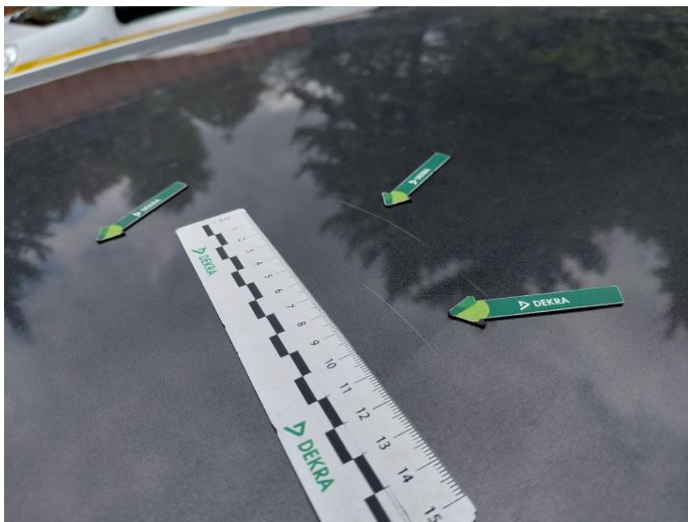
Fot. 47. Dach stały - zarysowanie 1
