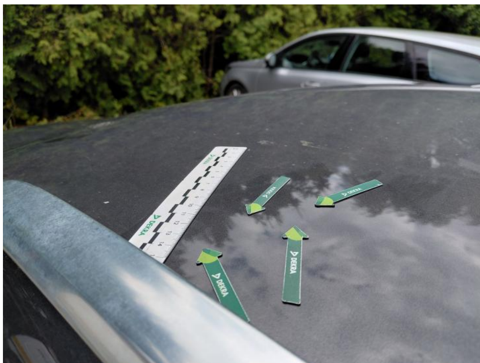
Fot. 51. Dach stały() - wgniecenia w ilości pow. 3 3
