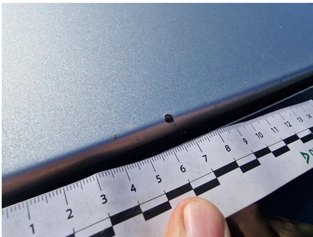
Fot. 64 Dach - Rysa/odprysk 2
