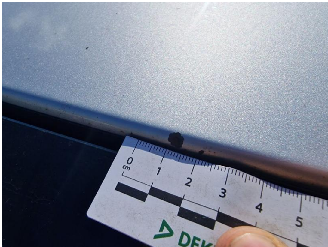
Fot. 63 Dach - Rysa/odprysk 1
