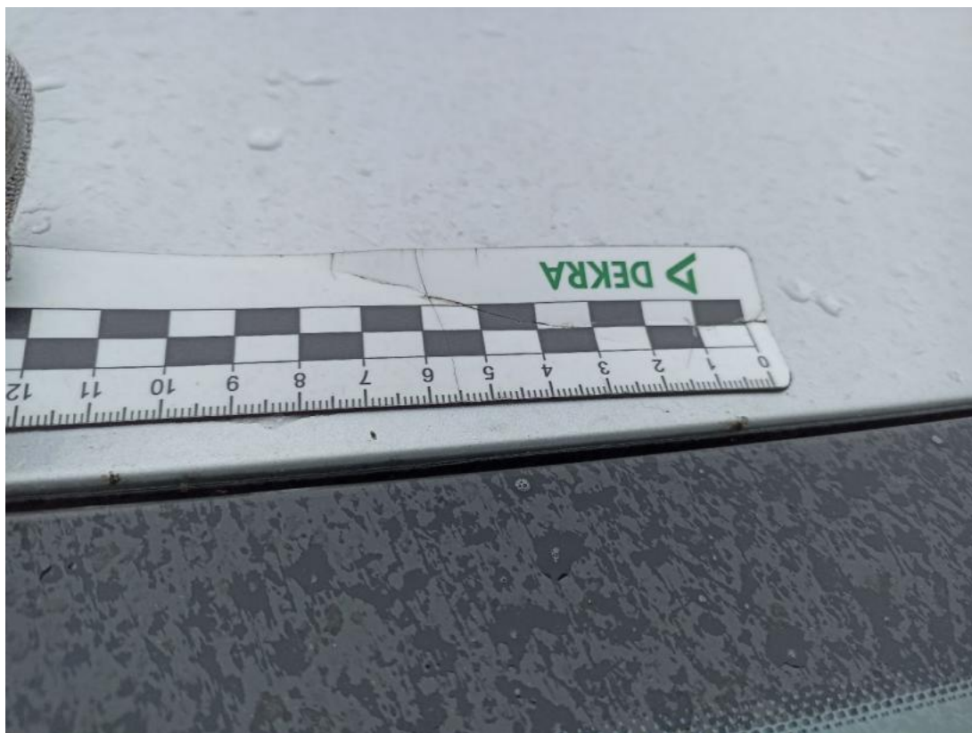
Fot. 41 Dach - Rysa/odprysk 1
