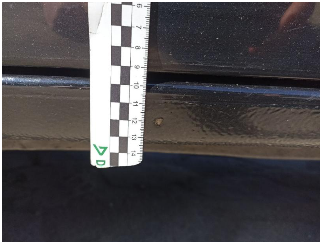
Fot. 53 Próg L - Rysa/odprysk 1
