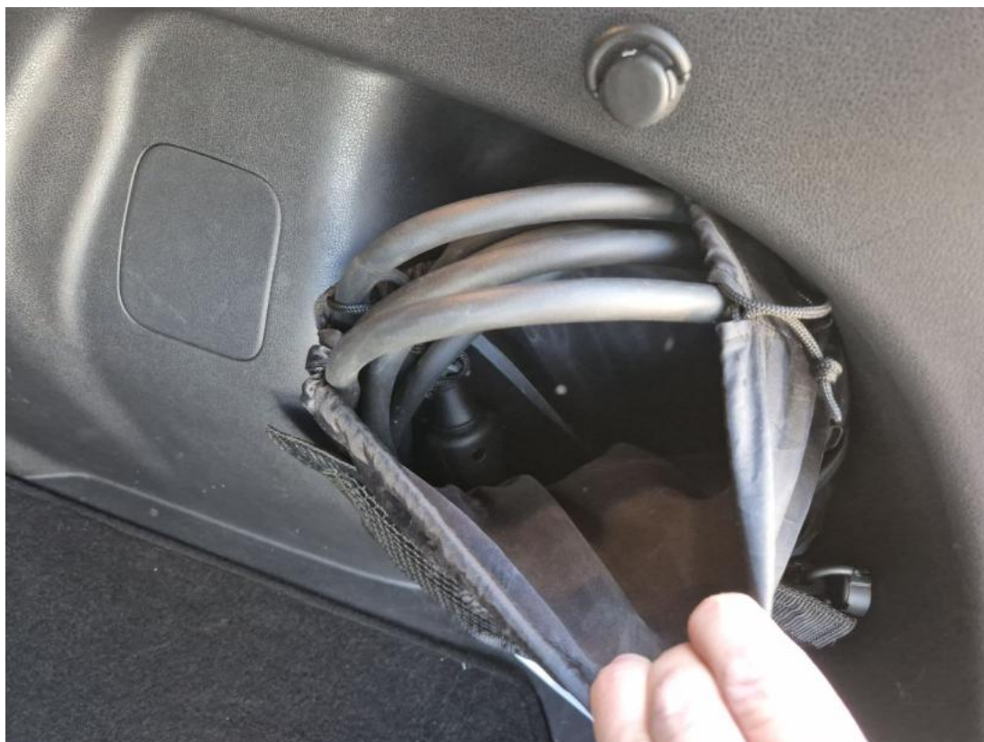
Fot. 27 Przewód ładowania baterii trakcyjnej
