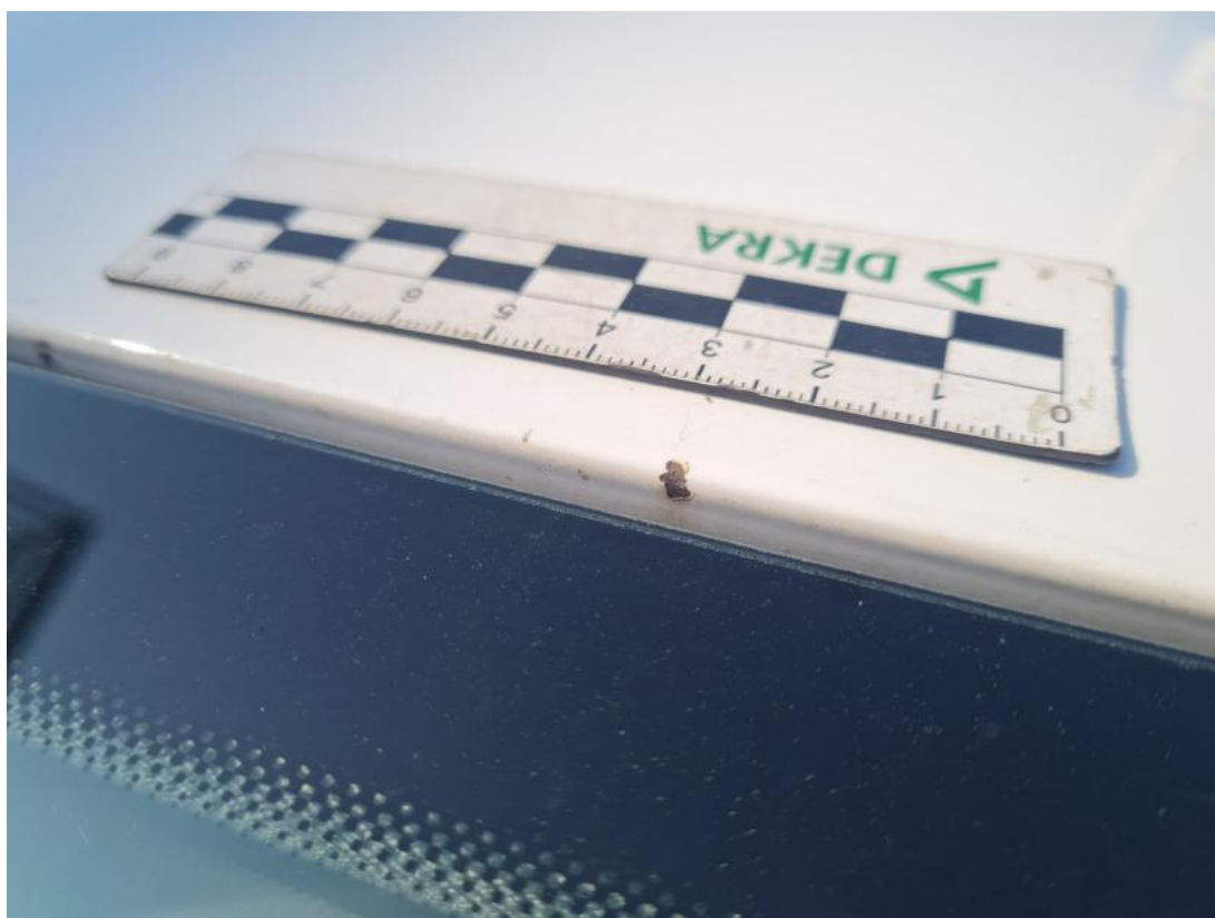
Fot. 54 Dach - Rysa/odprysk 1
