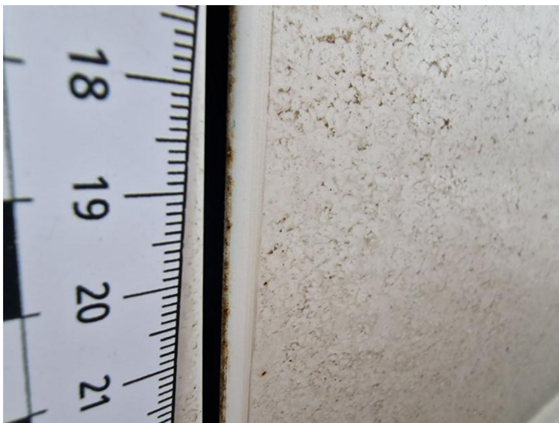
Fot. 57 Drzwi przed L - Inne 1
