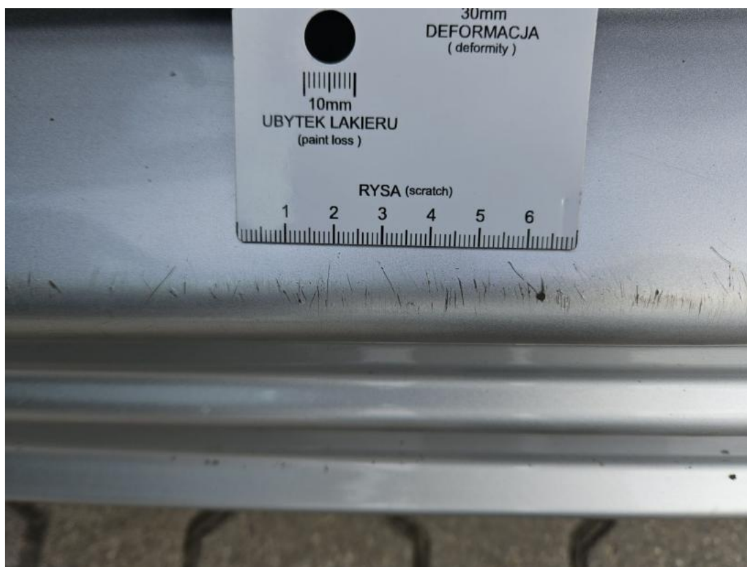
Fot. 56 Próg L - Rysa/odprysk 1
