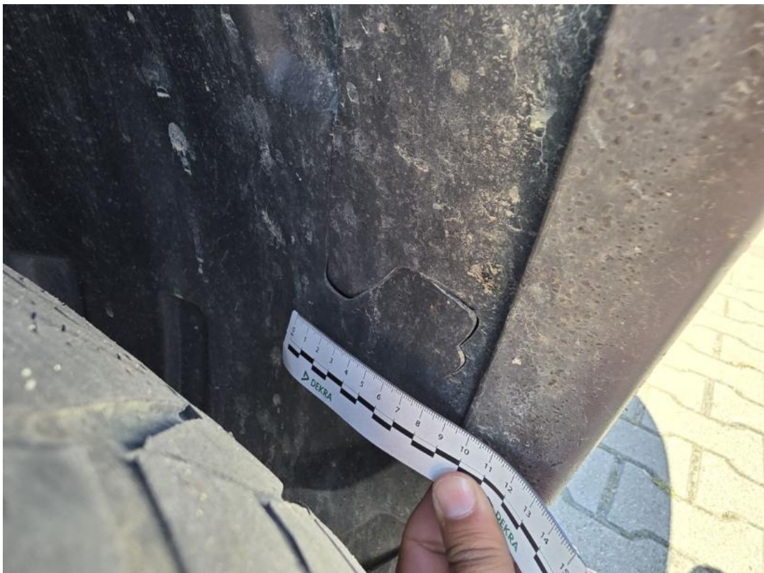
Fot. 52 Nadkole przednie P - Pęknięcie/rozerwanie 2
