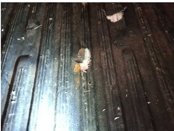
Beschädigung #4: Interieur: Laderaumboden - Löcher - erneuern
