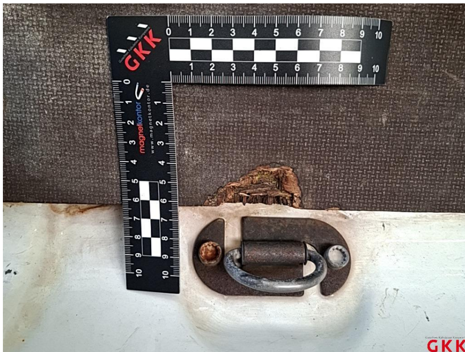
Bild 22 Laderaum, Bodenbelag Holz, beschädigt, ersetzen
