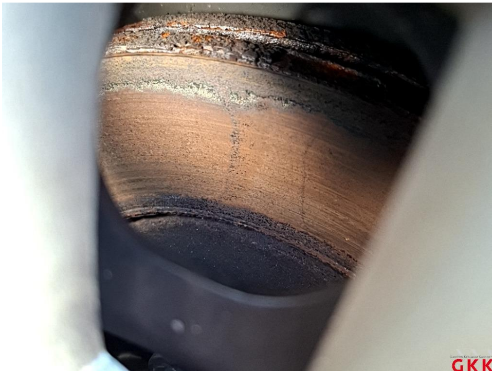
Bild 40 Reparaturkosten Hauptuntersuchung / gemäß Angabe des Auftraggebers, instand setzen
