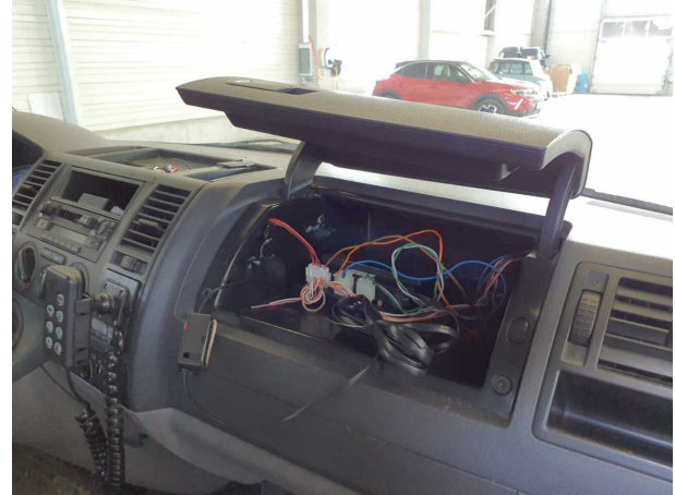
Beschädigung #8: Instrumententafel: Instrumententafel (Rückbauen) - abweichend Auslieferungszustand
