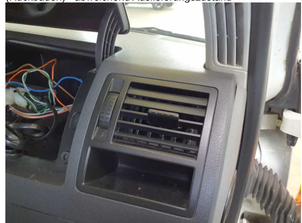
Beschädigung #9: Instrumententafel: Luftdüse rechts - gebrochen / gerissen - erneuern
