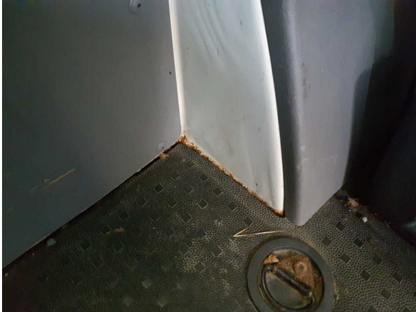
Beschädigung #13: Interieur: Innenraum - Korrosion - instandsetzen und lackieren
