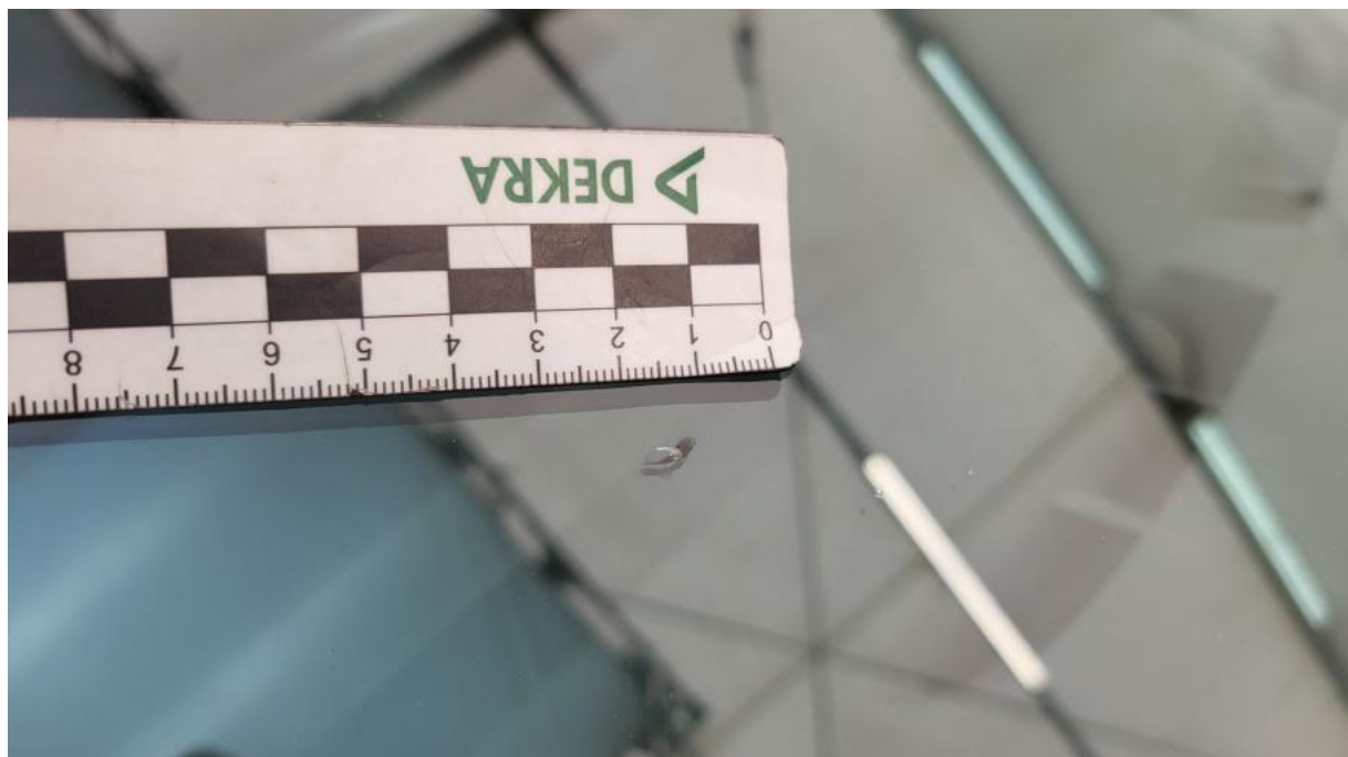
Fot. 32 Szyba czołowa - Pęknięcie/rozerwanie 1
