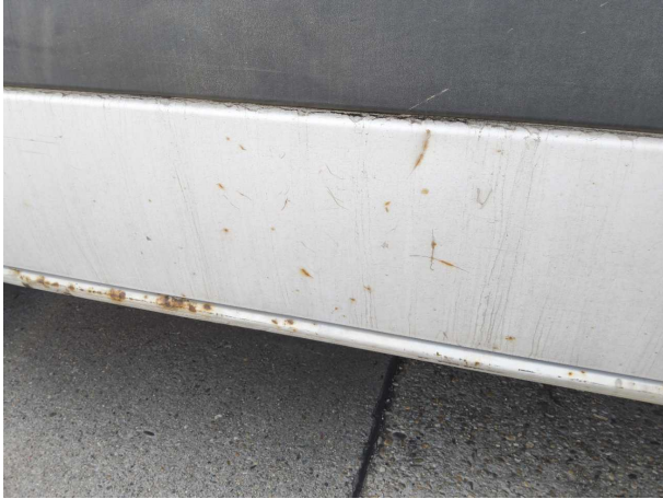
Beschädigung #7: Schiebetür rechts: Schiebetür - Korrosion - Wertminderung
