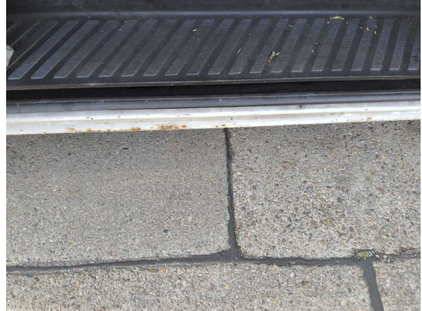
Beschädigung #6: Schweller rechts: Einstieg - Korrosion - lackieren
