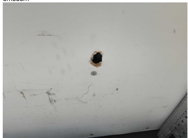
Beschädigung #5: Schiebetür rechts: Verkleidung Hartfaser unten - gebrochen / gerissen - erneuern
