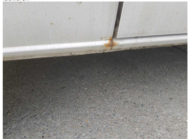
Beschädigung #6: Schweller rechts: Einstieg - Korrosion - lackieren
