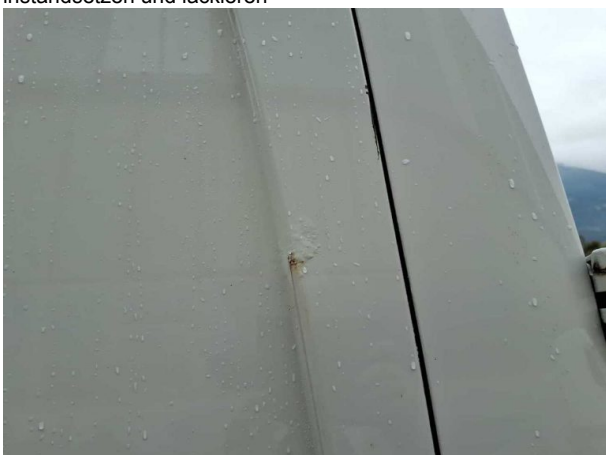
Beschädigung #34: Seitenwand links: Seitenwand - Korrosion - instandsetzen und lackieren
