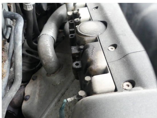
Bild 53: Technik / Motor Ölfeucht
