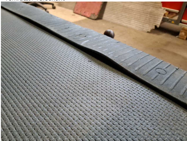
Beschädigung #5: Verkleidungen/Abdeckungen: Verkleidung Ladekante - gebrochen / gerissen - erneuern
