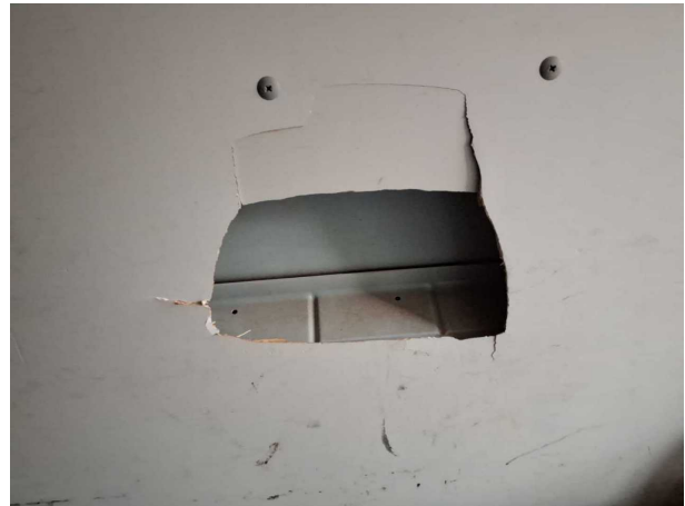
Beschädigung #3: Schiebetür rechts: Verkleidung Standard unten - gebrochen / gerissen - erneuern
