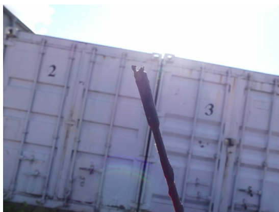
Bild 40: Technik / Antenne beschädigt
