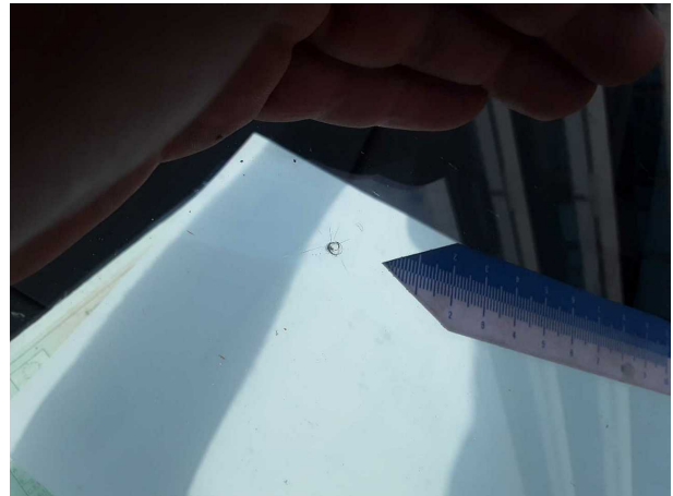
Beschädigung #1: Verglasung: Frontscheibe - Steinschlag - erneuern
