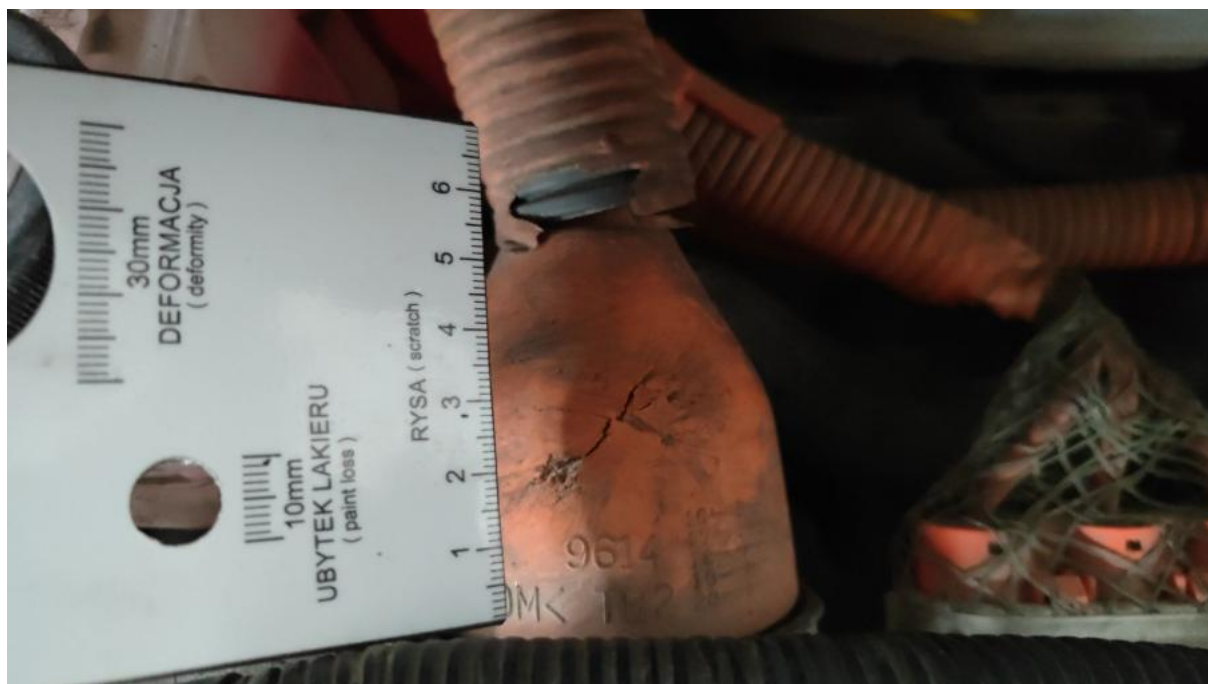
Fot. 33 przewody wysokiego napięcia
