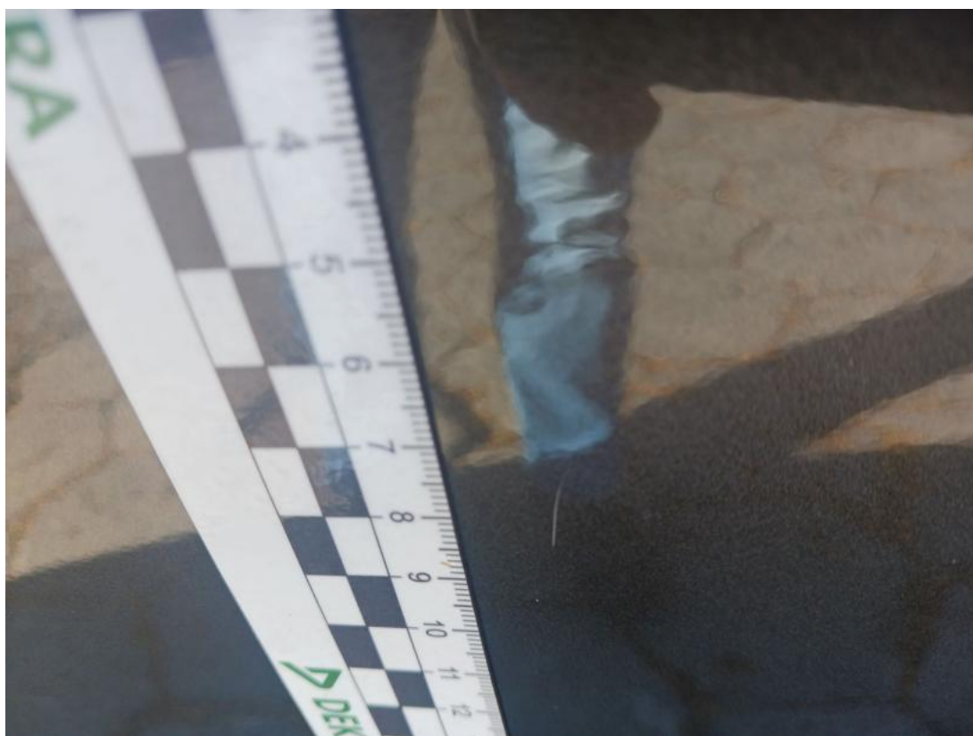
Fot. 62 Drzwi przed L - Wgniecenie/odkształcenie 1
