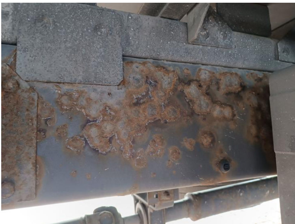
Fot. 86. Rama - korozja 2
