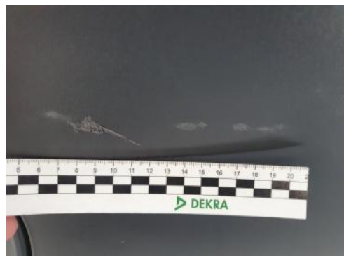
Fot. 52 Wykładzina pokrywy tylnej - Rysa/odprysk 1
